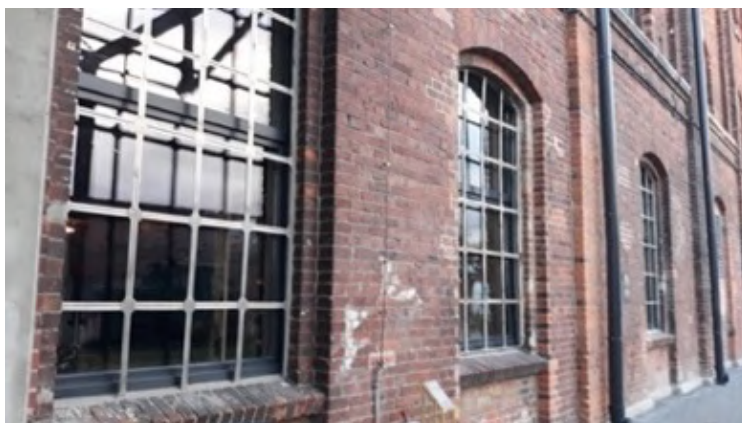
Fot. 25. Cukrownia Żnin adaptowana na hotel, wprowadzono współczesne okna dwudzielne, dla efektu wizualnego zastosowano kratę zewnętrzną imitującą dawne podziały okna (Ł. Konarzewski)
