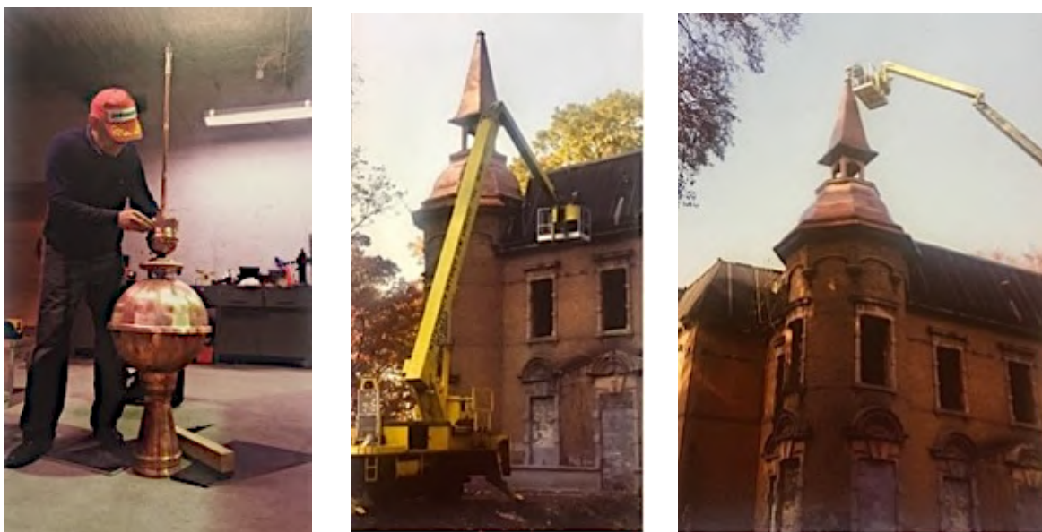
Fot. 128., 129. i 130. Janusz Gładysz przy pracy nad iglicą wieży; montaż nowej kopuły i iglicy (2015) (archiwum prywatne rodziny Gładysz)
