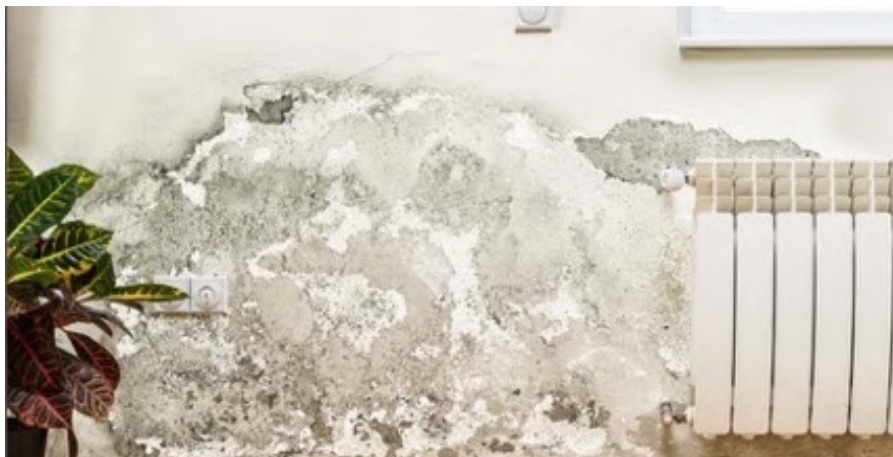
Fot. 14. Zagrzybienie ściany ( https://www.budnews.pl/grzyb-i-plesn-na-scianie-trzeba-z-tym-walczyć/ )
