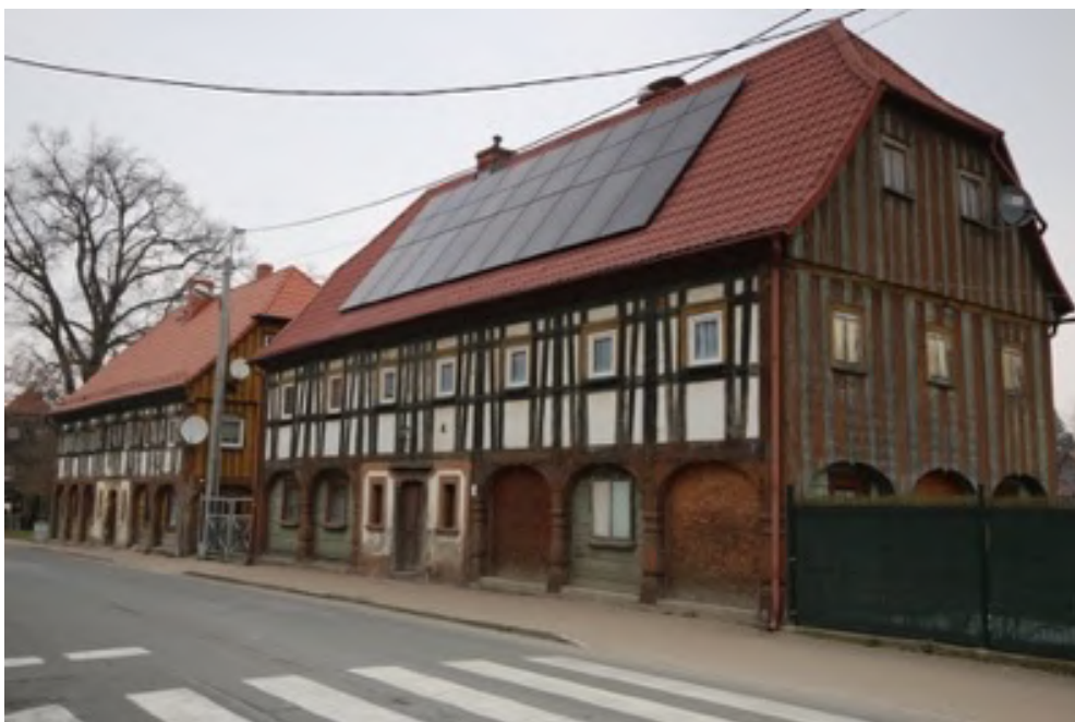
Fot. 44. Instalacja fotowoltaiczna na frontowej połaci dachu domu szachulcowego w Bogatyni (Z. Purchala)
