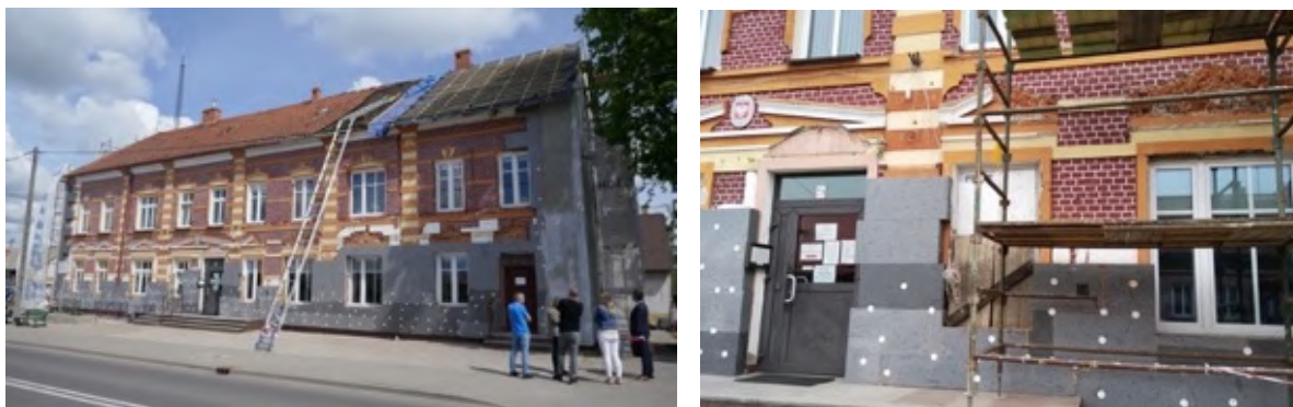
Fot. 6. i 7. Elewacja frontowa Urzędu Gminy Banie Mazurskie po wstrzymaniu prac termomodernizacyjnych przez Warmińsko-Mazurskiego Konserwatora Zabytków; skute detale na elewacji frontowej
